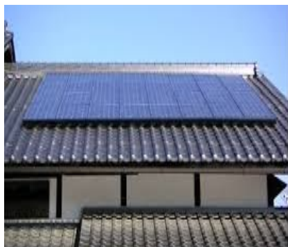
太陽光発電設備
