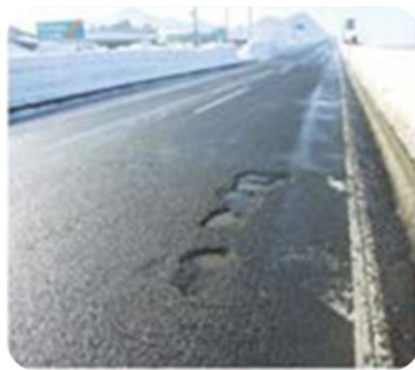
路面の穴ぼこ・ 段差
