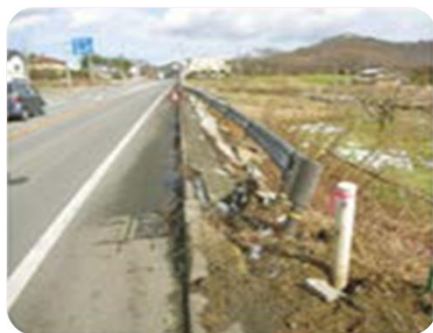
ガードレール・ 標識等の損傷
