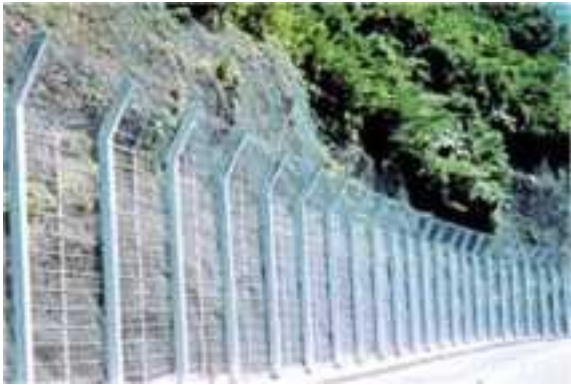
落石防護柵の例
