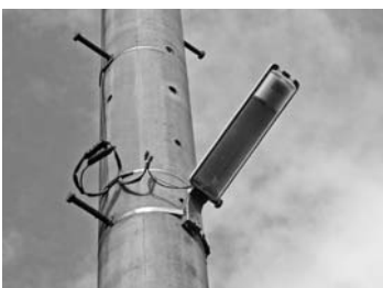
写真＝LED化された防犯灯
