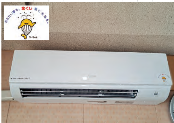
▲整備されたエアコン
