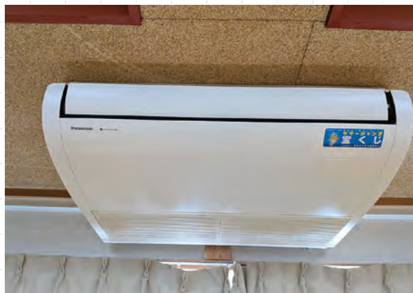
▲整備されたエアコン
