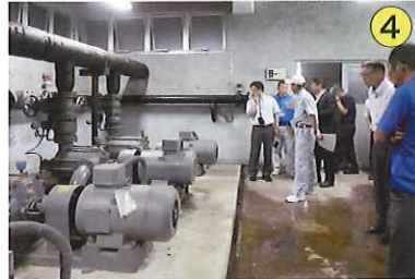
豊富な地下水をくみ上げている横吹ポンプ場（谷川）
