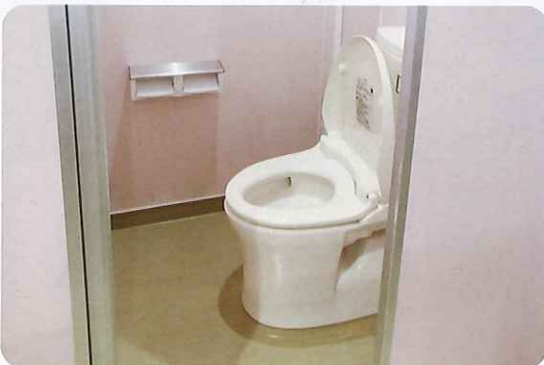
昨年度改修された古馬牧小学校のトイレ
