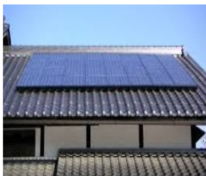
太陽光発電設備
